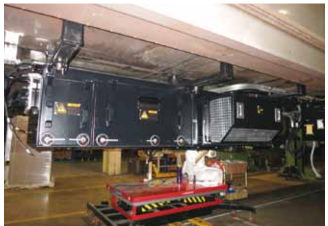
図8 VVVF インバータ制御装置の架装状態
