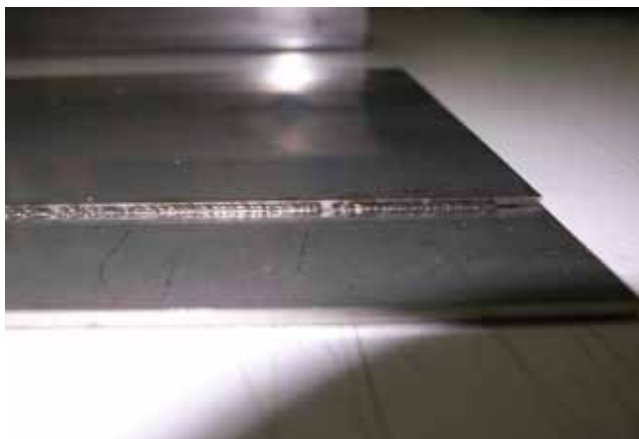
図 13 レーザ水密溶接撮像元画像（2 箇所未溶接部あり）
