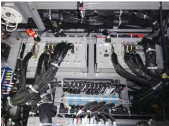
図9 室内機器室内
