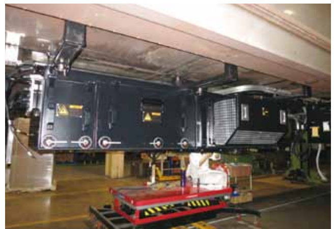
図8 VVVF インバータ制御装置の架装状態
