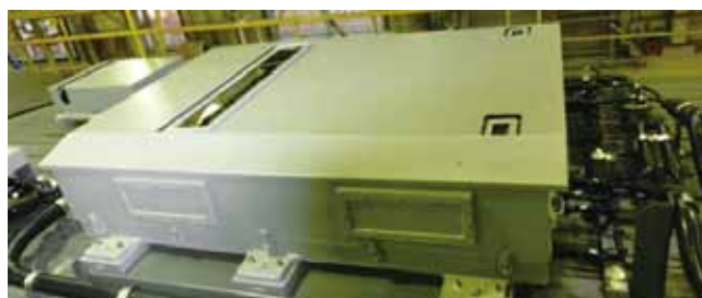
図7 電力モニタリング装置
