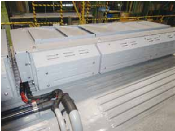
図8 屋上 主回路バッテリー
