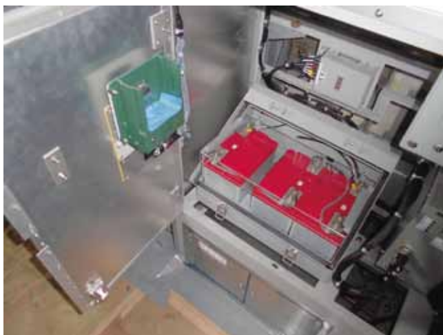
図 12 移動禁止システム専用蓄電池
