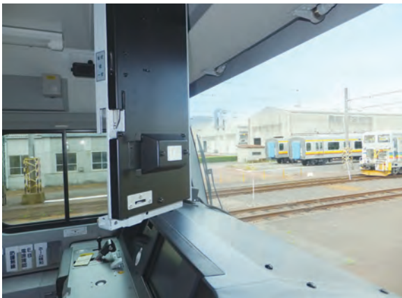
図8 時刻表灯に設置した携帯端末装置用コンセント
