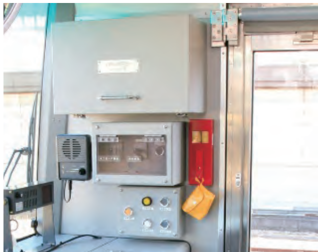
図7 架線認識異常扱いスイッチ箱
