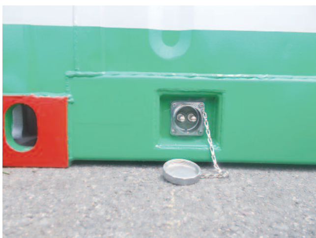
図6 電源供給コンセント
