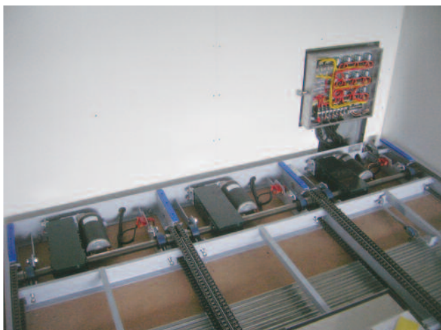
図4 電動モータおよび制御盤
