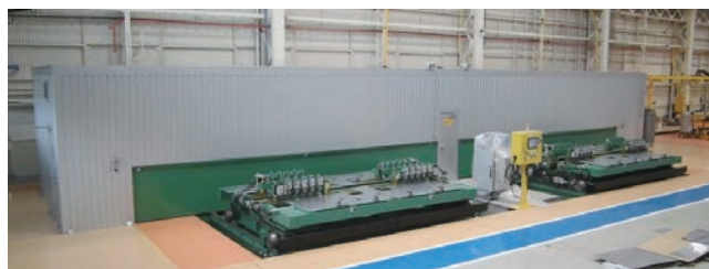
図 1 レーザ溶接設備
