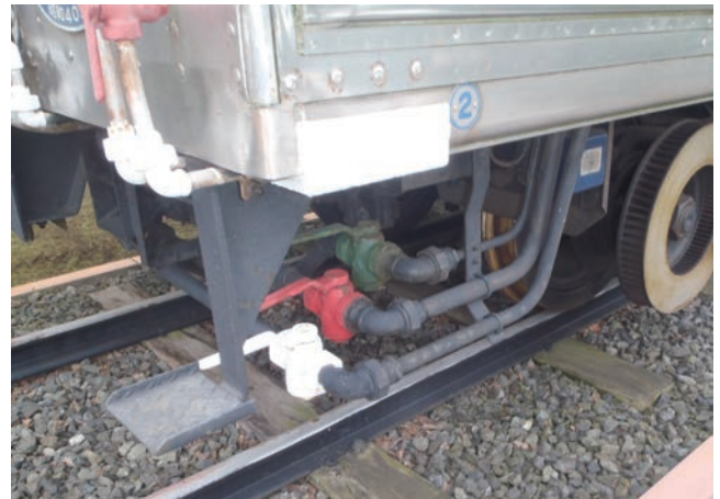
図6 車端部ボールコック
