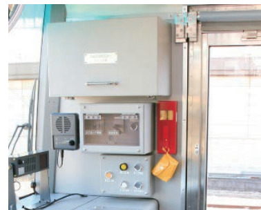
図 9 架線認識異常扱いスイッチ箱 (1)
